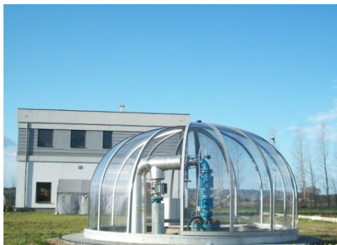
Fig. Geothermia Poddębice
