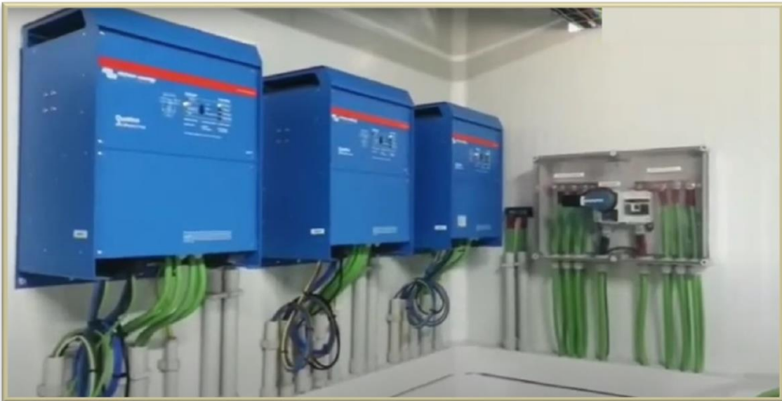
Image 3 : Onduleurs et régulateurs de tension et de tension
