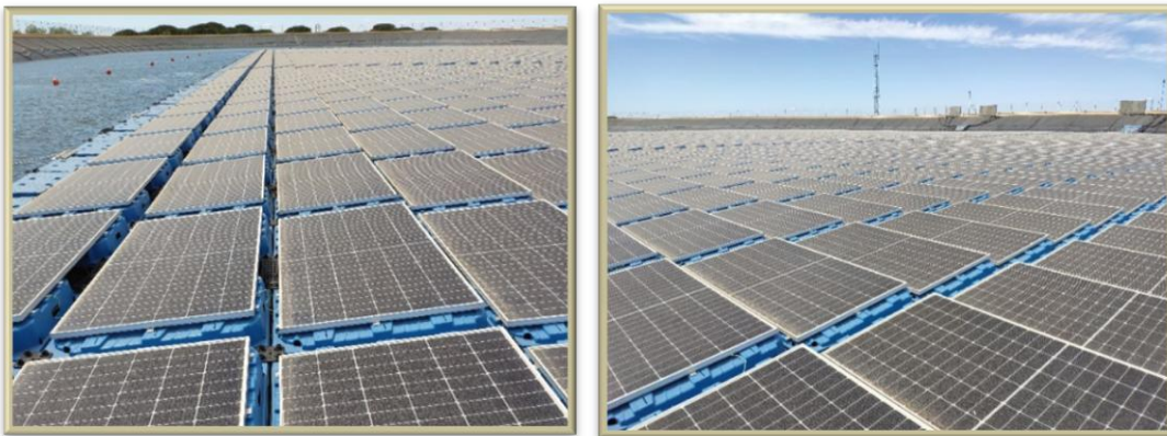
Image 2: Detalle de la instalación fotovoltaica flotante Fuente: Aportada por la empresa
